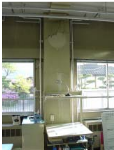
写真 3.2.7 せん断破壊した柱（内側から）
