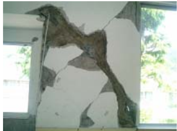
写真 3.3.9 方立て壁の破壊状況
