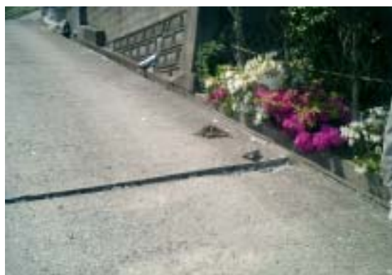
写真 3.4.10 高台への坂道 手前側が落下し、亀裂が生じている。
