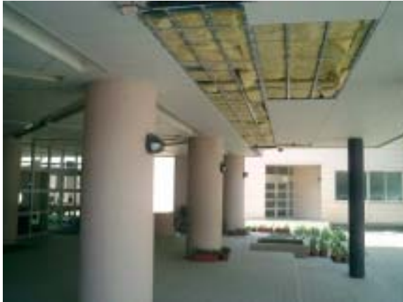
写真 3.3.11 玄関の天井ボードの落下 一部は危険のため地震直後に取り外した。
