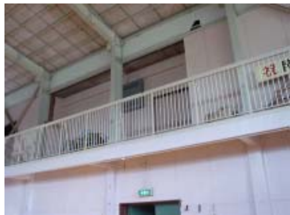
写真 3.5.8 体育館天井 仕上げボードが一部落下している
