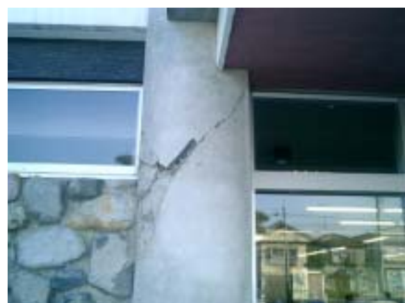
写真 3.2.4 右側の柱のせん断ひび割れ 片側せん断ひび割れ、コンクリートの剥落
