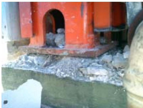
写真 3.5.2 柱脚部の破損（新棟の塔屋）
