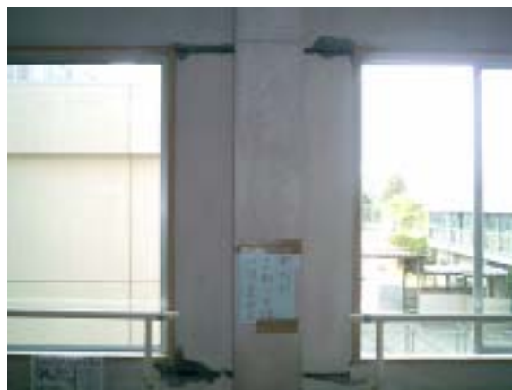
写真 3.5.4 廊下側の構面の柱と袖壁 柱、袖壁の水平ひび割れ
