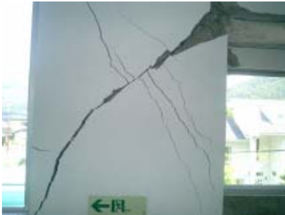
写真 3.3.8 方立て壁のせん断ひび割れ
