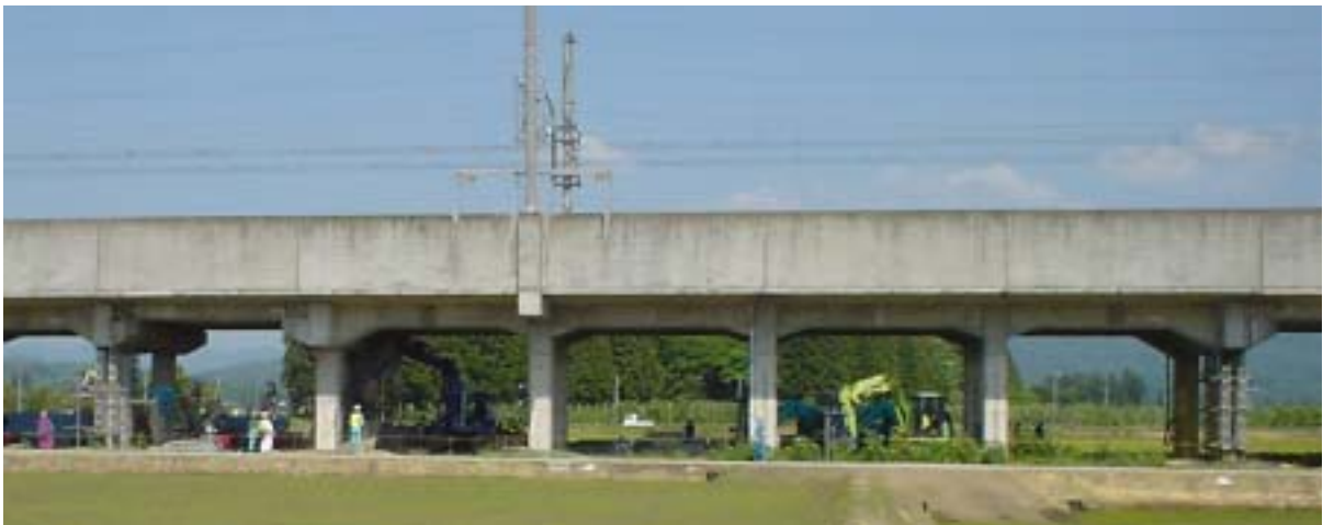
写真 3.1.3 橋脚 No.6 ~ No.11 (最左が No.6、最右が No.11) No.6 ~ No.7 間が単純桁橋、No.7 ~ No.11 間が 4 径間ラーメン橋である。
