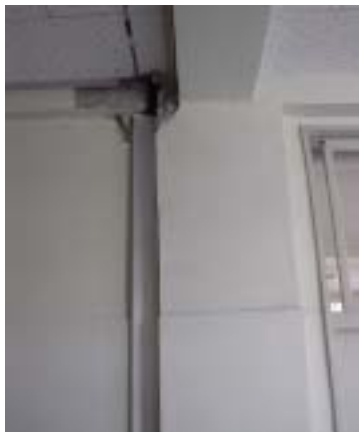
写真 3.4.5 エクスパンション・ジョイント
