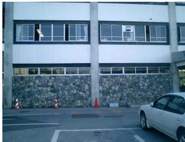
写真 3.2.2 中央館北面の東側の2スパン 高い腰壁により柱が短柱化している。
