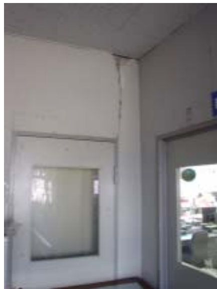
写真 3.2.11 柱と壁の接続部（東館） 継ぎ目でひび割れが生じている。
