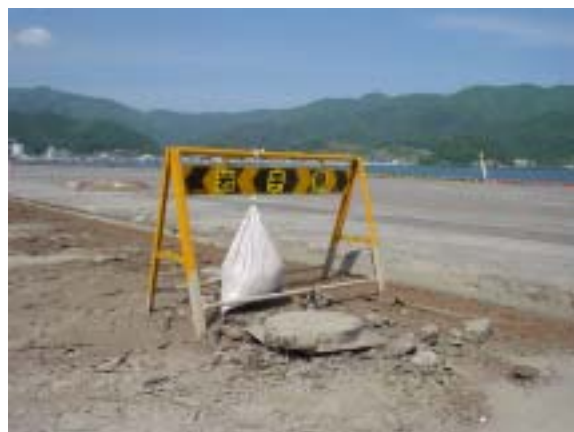
写真 3.4.12 液状化現象の痕跡 乾燥した噴砂が散在している。
