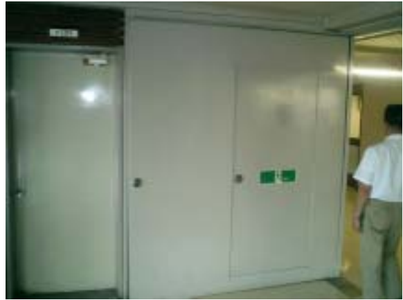
写真 3.2.9 防火扉 建物の変形により閉じられなくなった。
