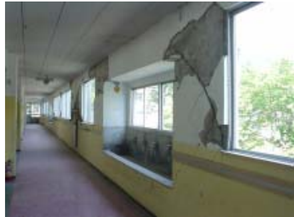
写真 3.3.7 北面の外壁（室内より） ひび割れが大きく開き、仕上げモルタルの剥落も激しい。
