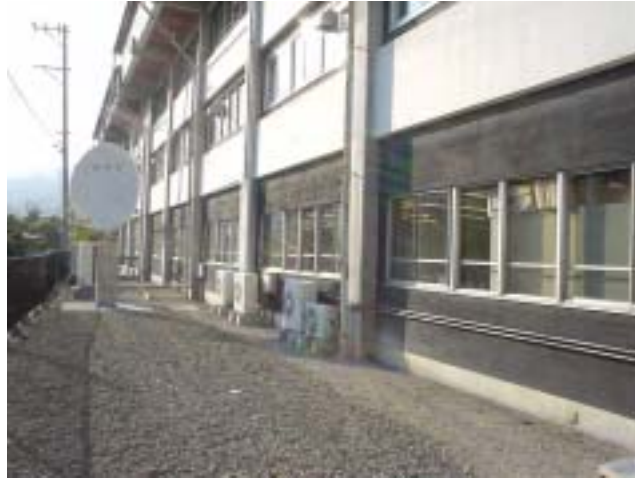
写真 3.2.5 中央館南面 手前から4番目の柱のみせん断破壊している。
