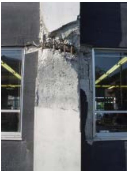
写真 3.2.6 せん断破壊した柱（外側から）
