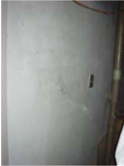
写真 3.2.8 南北中央構面の耐震壁 せん断ひび割れ、コンクリートの剥落
