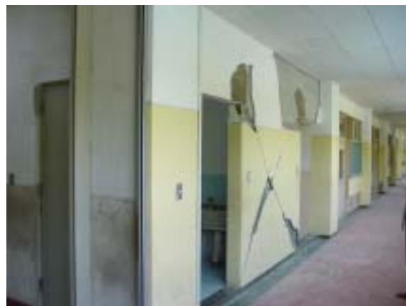
写真 3.3.10 トイレ入り口の方立て壁 X字型のせん断ひび割れ
