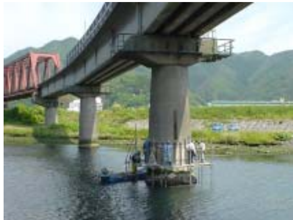
写真 3.3.17 応急補修中の橋脚 曲げ降伏による脚部の損傷と思われる。
