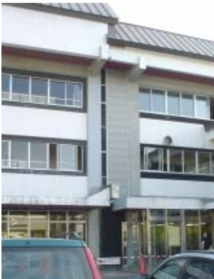
写真 3.2.10 中央館と西館の間の Exp.J 最上階つなぎ部材のコンクリートの破損
