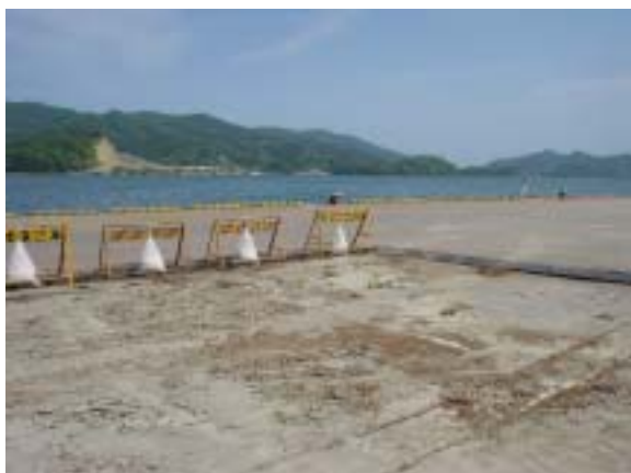
写真 3.4.12 液状化現象の痕跡 手前が沈下している。
